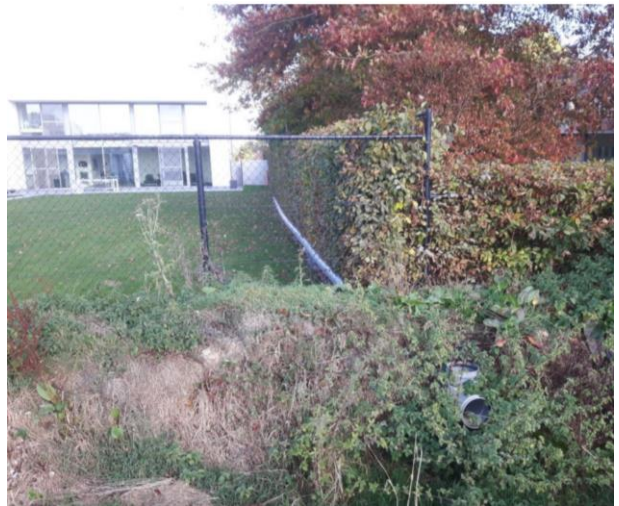
Foto 9 : aarden dam achteraan tuin met leegloopbuis naar straat
